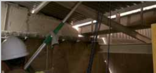
Pértiga de acceso al punto de anclaje del equipo
